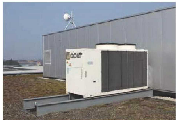
Het nieuwe complex is uitgerust met een Colt Calorissysteem, dat gebaseerd is op een gesloten ringnet waarop lokale warmtepompen worden aangesloten.
